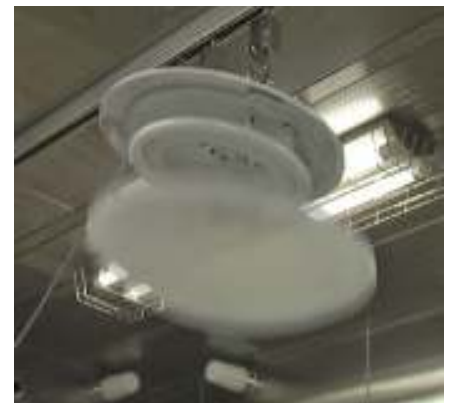
取り付けが不完全だったために 蛍光灯のカバーが落下した
